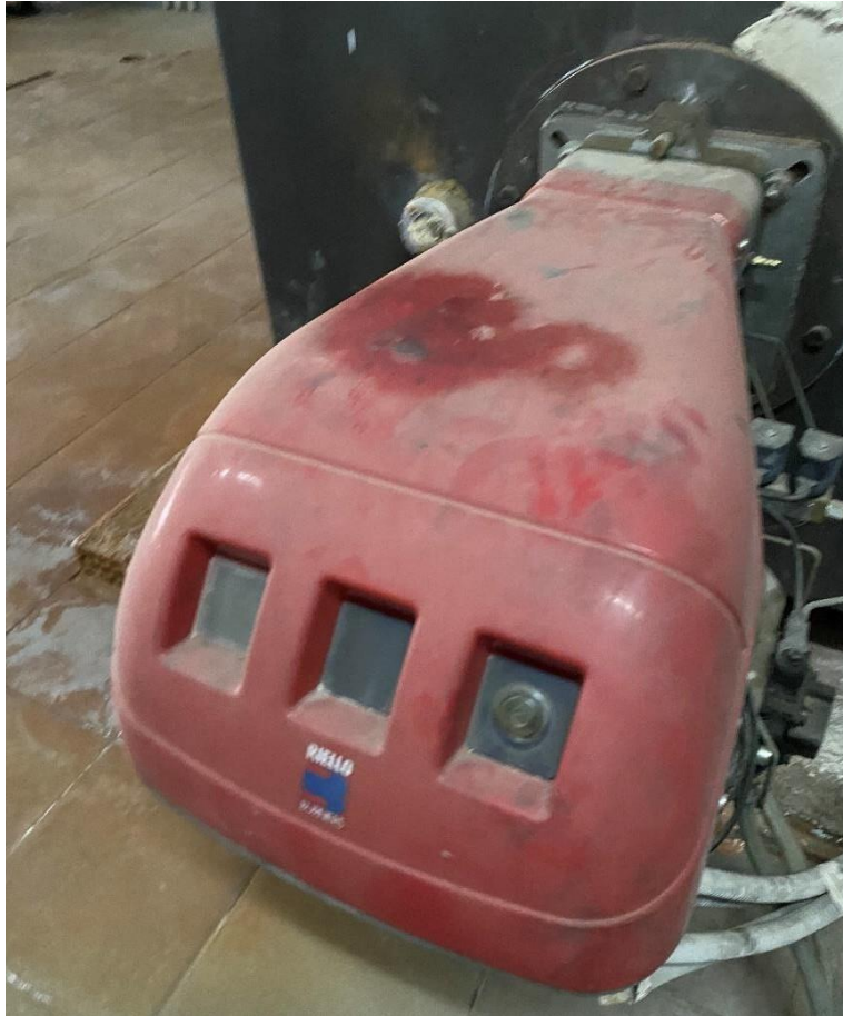
Εικόνα 65 Ο καυστήρας του λέβητα
