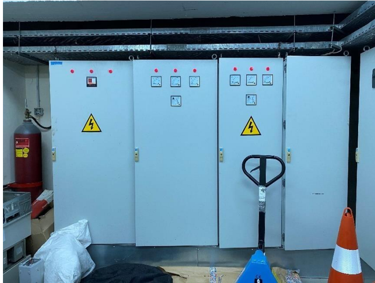
Εικόνα 82 Ηλεκτρολογικός πίνακας του κτιρίου
