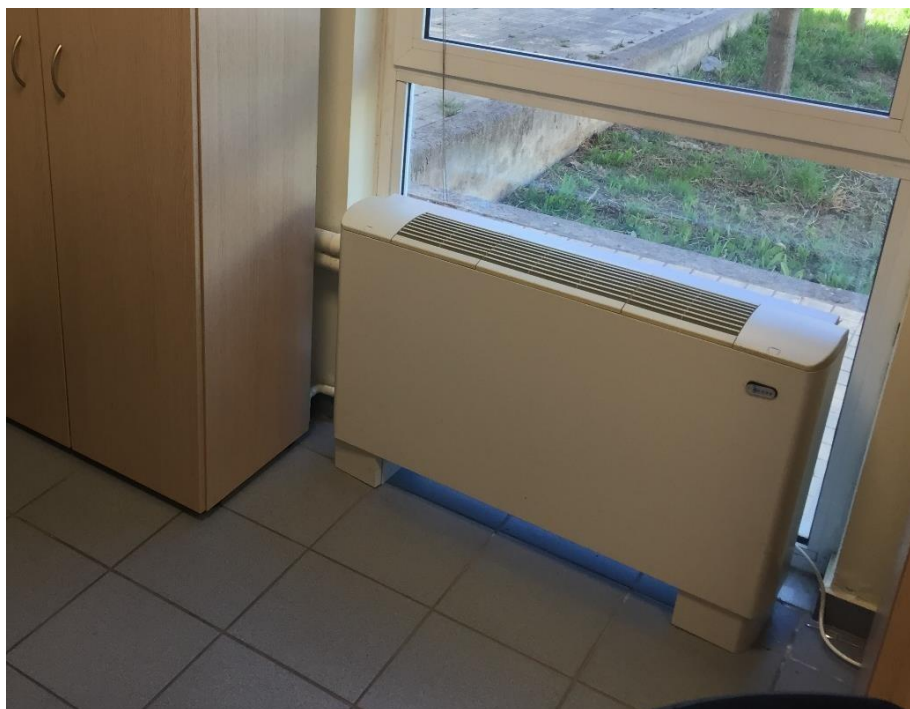
Εικόνα 71 Ενδεικτική μονάδα fan coil του κτιρίου
