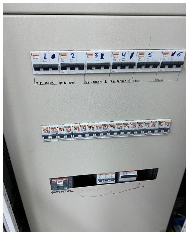
Εικόνα 83 Ηλεκτρολογικός πίνακας του κτιρίου
