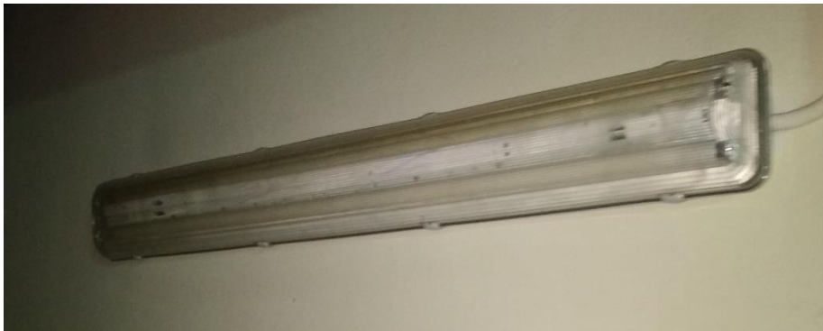
Εικόνα 79 φωτιστικό σώμα Β
