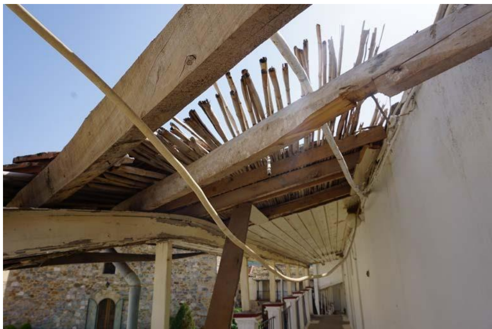
Άποψη της κατάστασης της στέγης στο δυτικό τμήμα της νότιας πτέρυγας στην οποία είναι εμφανής και η κατασκευαστική της λογική, Σεπτέμβριος 2021 (προσωπικό αρχείο της Ι. Βομπίρη)
