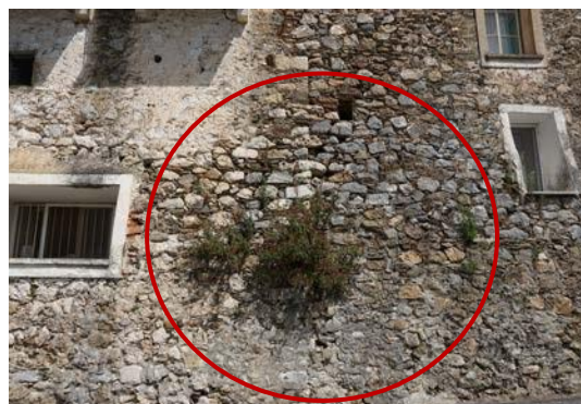
Απόπλυση συνδετικού κονιάματος στη βάση της νότιας εξωτερικής όψης και ανάπτυξη βλάστησης (προσωπικό αρχείο της Ι. Βομπίρη)
