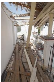
Άποψη της κατάρρευσης της στέγασης του εσωτερικού εξώστη, Σεπτέμβριος 2021
