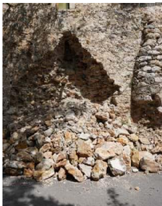
Εκτεταμένη κατάρρευση εξωτερικής παρειάς της τοιχοποιίας στη βάση της εξωτερικής νότιας νότιας όψης, Σεπτέμβριος 2021
