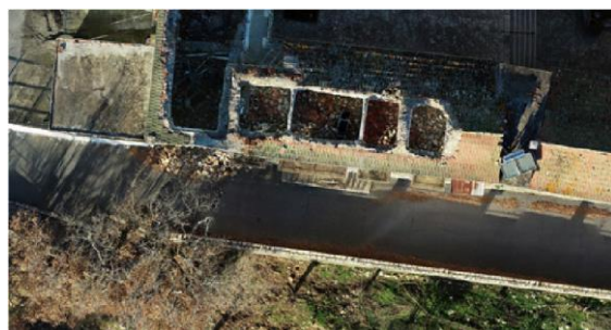
Αεροφωτογραφία στην οποία διακρίνεται η κατάσταση της στέγης του δυτικού άκρου της πτέρυγας, Σεπτέμβριος 2021
