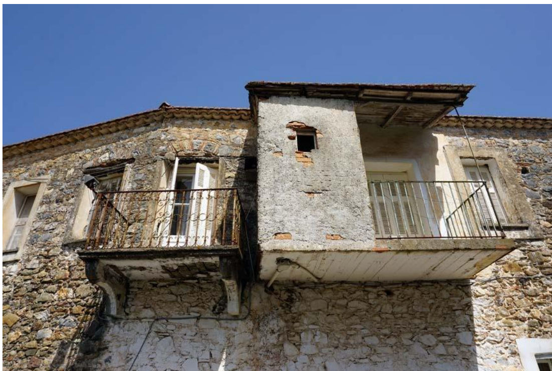
Άποψη νεώτερου εξώστη από οπλισμένο σκυρόδεμα στη νότια πτέρυγα, Σεπτέμβριος 2021 (προσωπικό αρχείο της Ι. Βομπίρη)
